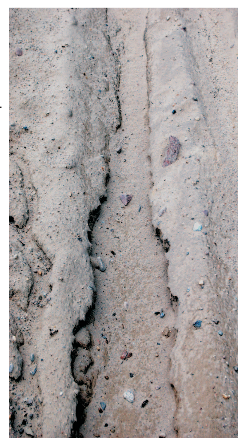
Rillenbildung durch Wassererosion
